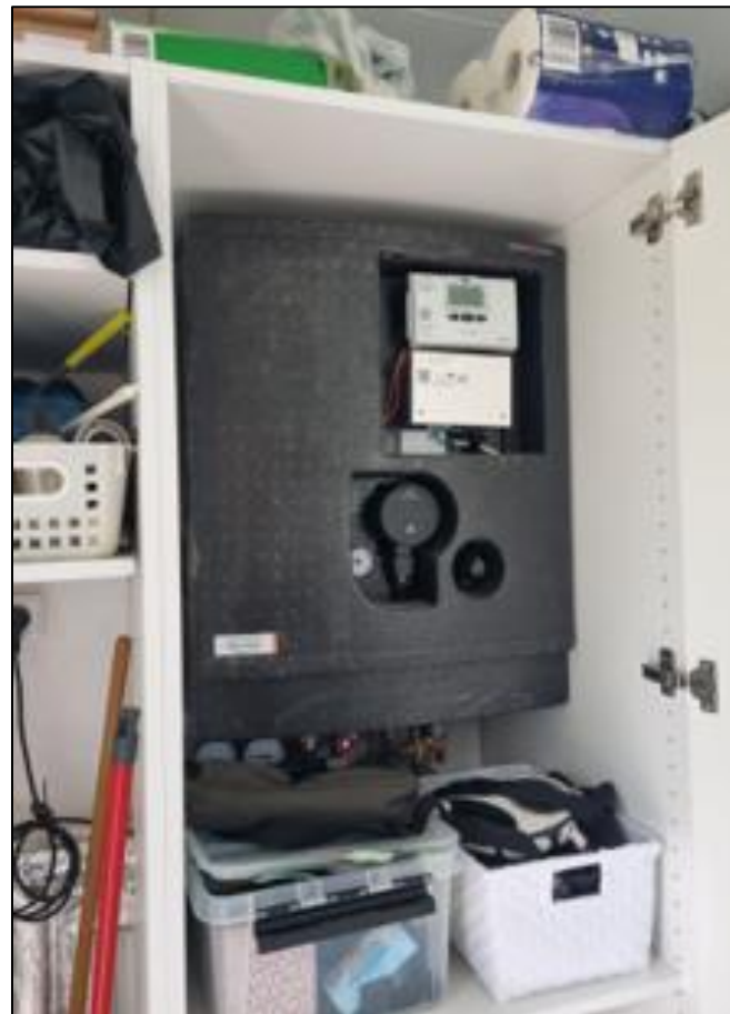
Anlæg indbygget i skab
